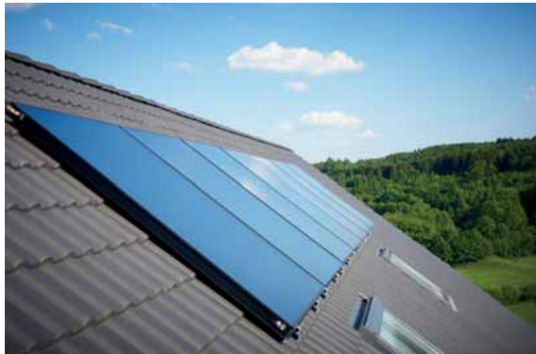
Pločasti kolektori montirani na kosi krov
