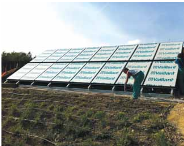
Instalacija kolektorskog polja
